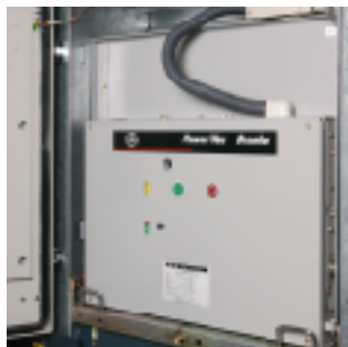
断路器在柜内试验位置
